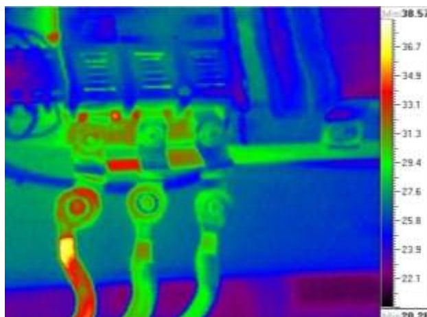
Рисунок 21. Пример термограммы контактных соединений с температурной шкалой
