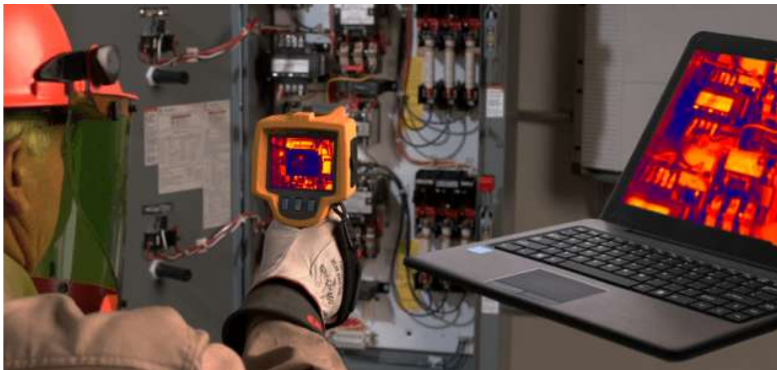
Рисунок 20. Пример проведения тепловизионного контроля электрошкафа
